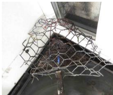
Figura 13: grilaj din otel care protejează arzătorul principal de reziduurile care cad.
